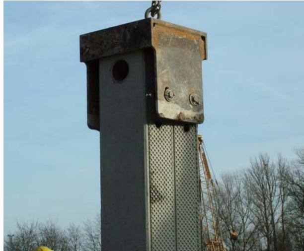
Bild 11: Vorrichtung zur Aufnahme der Fertigteile
